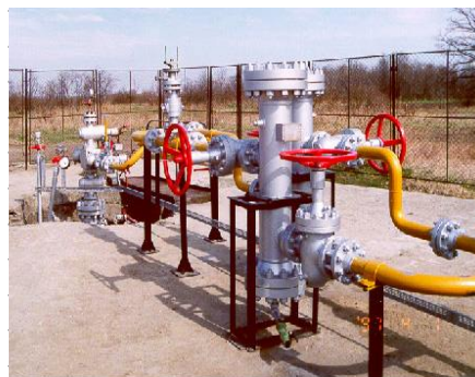
5. ábra egy földgázút beépített szűrőrendszere
