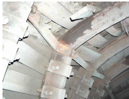
5. ábra: A rosszul elhelyezett távtartók megakadályozzák a TH-ívek összecsisúsítását
